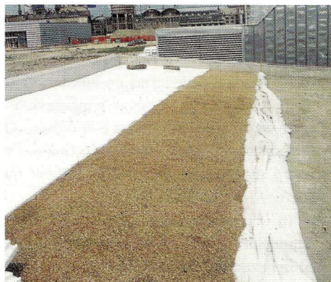
Foto 1 - Fase di cantiere: si notano i diversi strati drenanti e di accumulo idrico utilizzati, e il tessuto non tessuto posto a copertura.
